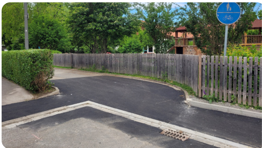
Beim gemeinsamen Geh- und Radweg zum Kindergarten an der Bodenseestraße wurden die Bordsteine komplett abgesenkt. Auch diese Maßnahme haben die Bauhofmitarbeiter ausgeführt.
